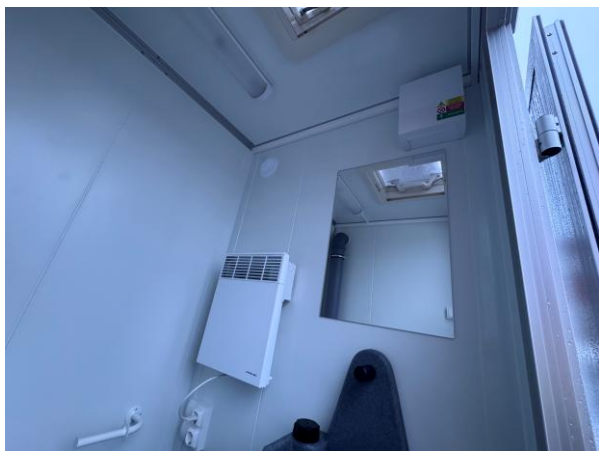
Ventilasjonsluke, takluke, sikringsskap og LED-lys i taket med bryter
